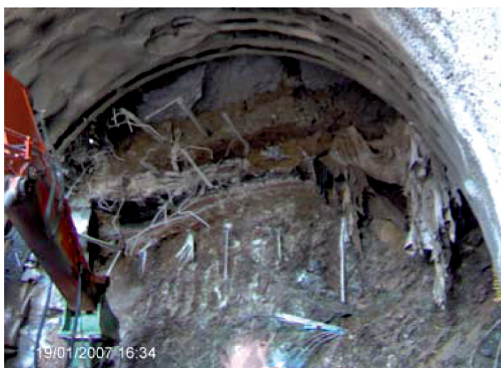
Fig. 4.19. – Fase di scavo a valle SS Del Cerreto (si nota muro esistente ancorato e paratia in micropali alla sua base).
