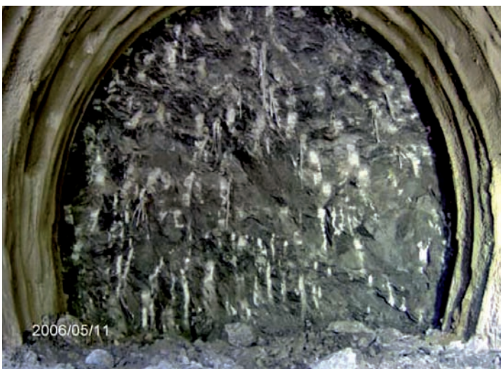
Fig. 4.14 – Scavo galleria Dorbola da Lucca (progr. 1+233). Fronte di scavo in Argilliti. Sezione tipo applicata V/B.
