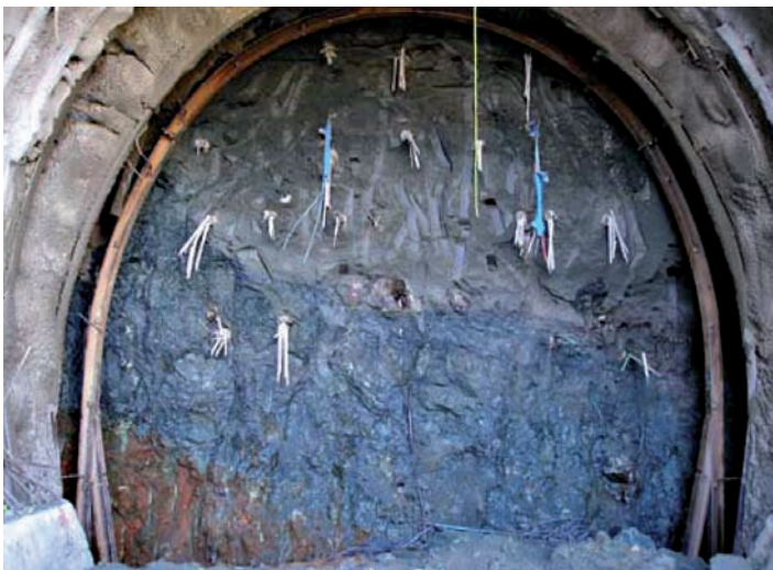
Fig. 4.12. – Scavo galleria Dorbola da Aulla. Prime progressive di imbocco, si notano i depositi fluvio-lacustri a sormonto delle argilliti. Nel lembo inferiore sx iniziano ad affiorare le Ofioliti. Sezione tipo applicata V/C2.
